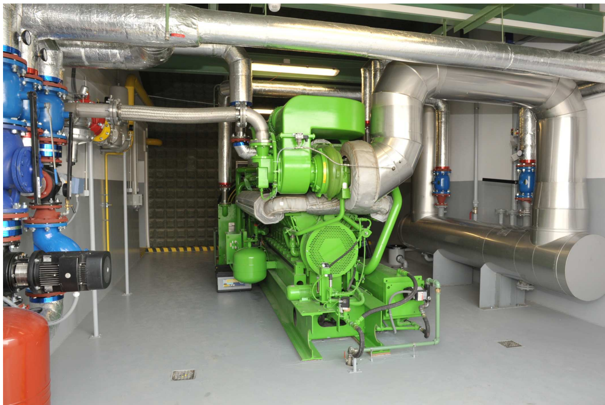
Fotografia 1 Układ do skojarzonego wytwarzania energii elektrycznej i ciepła w Koczale. (Poldanor S.A).
