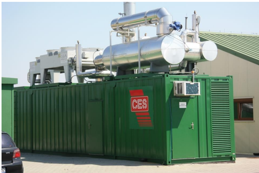
Ryc. 23 Agregat kogeneracyjny, biogazownia nr 2
