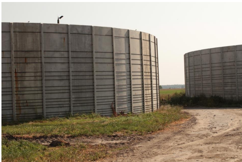
Ryc. 17 Zbiorniki do przechowywania płynnej masy pofermentacyjnej, biogazownia nr 1
