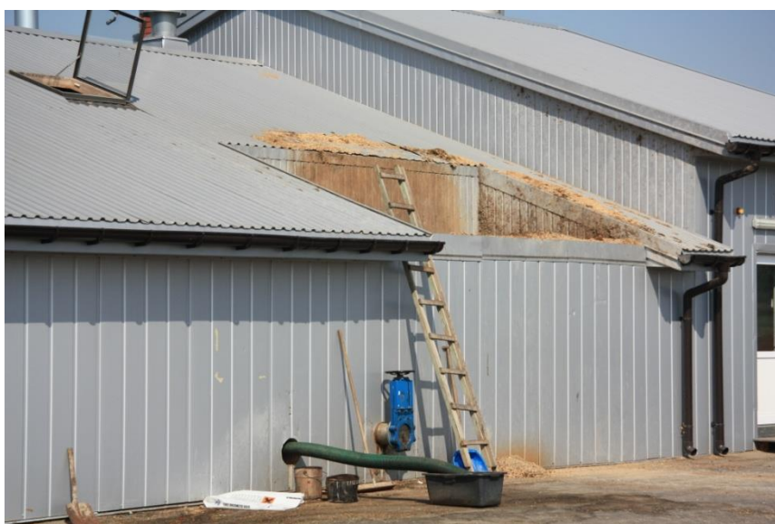
Ryc. 13 Stacja przyjęć substratu, biogazownia nr 1
