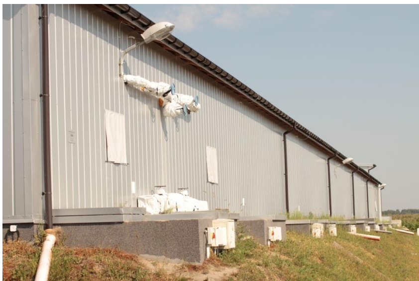
Ryc. 18 Komora fermentacyjna, biogazownia nr 1
