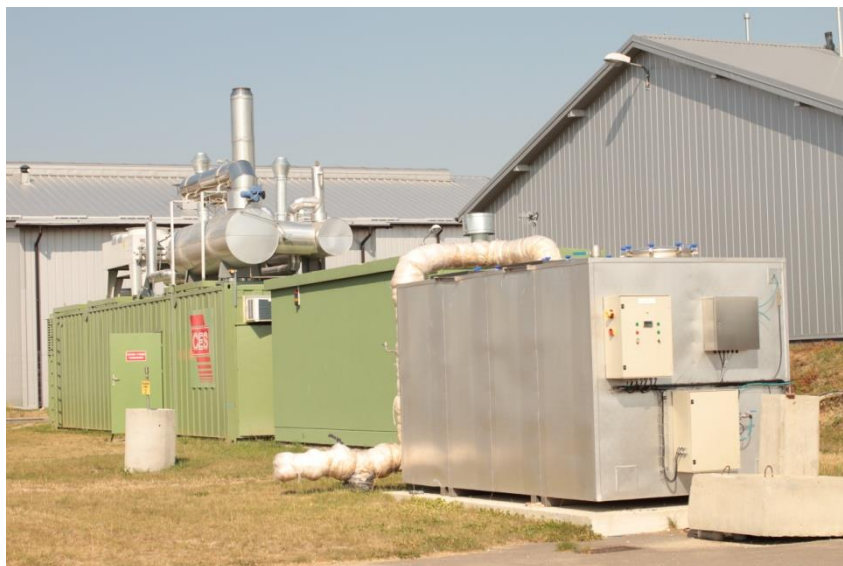
Ryc. 15 Agregat kogeneracyjny, pochodnia i stacja odsiarczania, biogazownia nr 1
