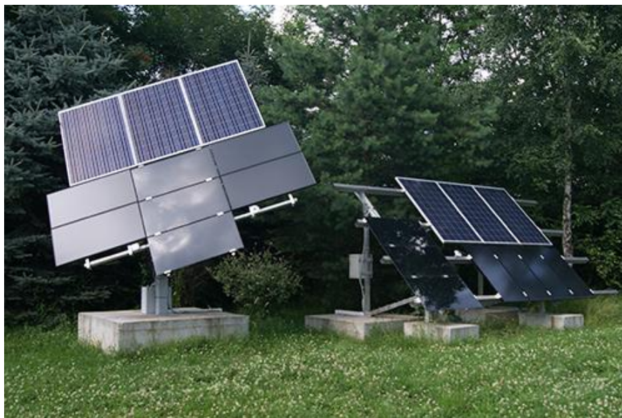
Panele fotowoltaiczne umieszczone na trackerze i stelażu stałym (fot. ChronmyKlimat.pl)
