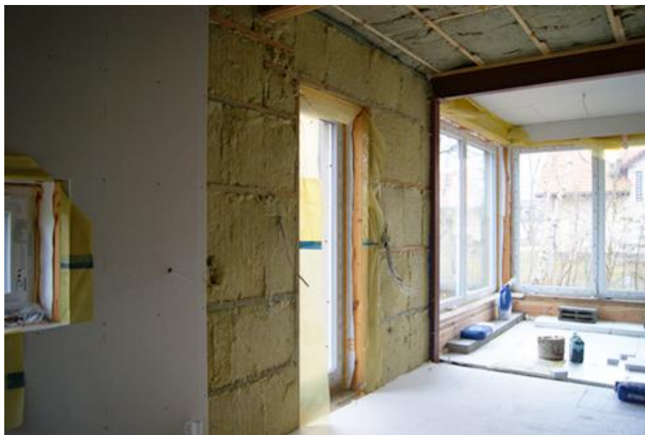
Drewniany szkielet wypełniony izolacją z wełny mineralnej i styropianu (fot. ChronmyKlimat.pl)
