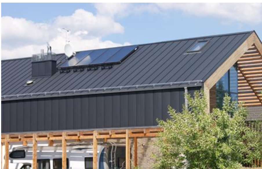
Kolektory słoneczne zamontowane na dachu budynku (fot. ChronmyKlimat.pl)
