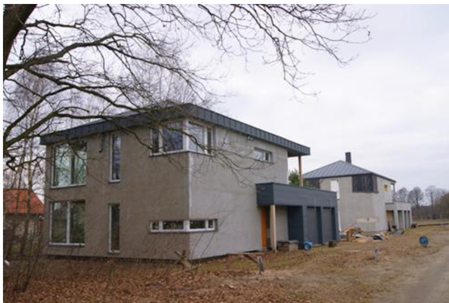
Dom pasywny w trakcie budowy oraz energooszczędny powstające na terenie osiedla (fot. ChronmyKlimat.pl)
