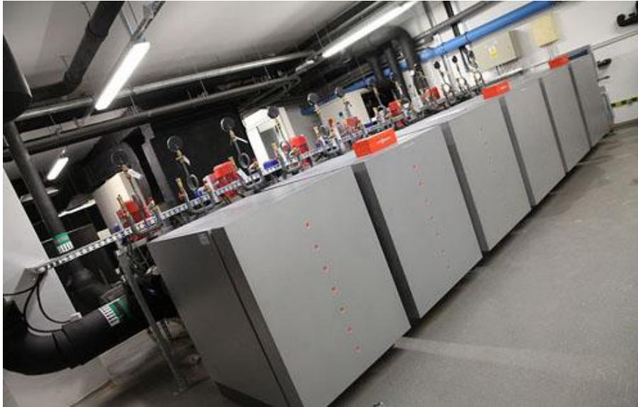
Kaskada pomp ciepła (fot. Euro-Centrum Park Naukowo-Technologiczny)
