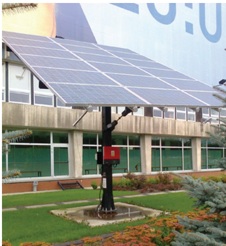
Fot. 10.1. Instalacja PV jednoosiowy system śledzenia położenia słońca
