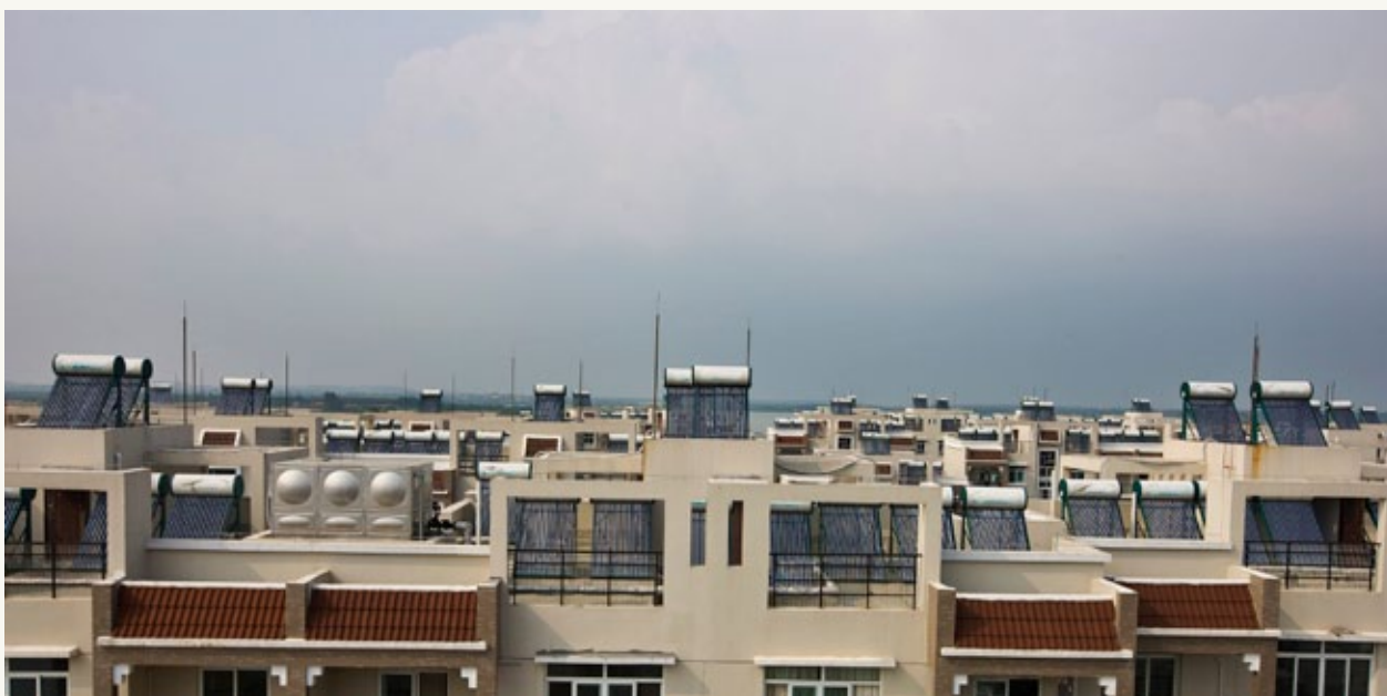
Kolektory słoneczne, Wuhan City, Chiny
