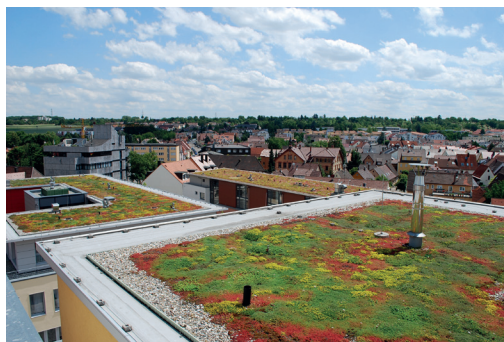
Dach zielony ekstensywny (z rozchodników) na budynku wielorodzinnym. Fot. Optigruen International AG.
